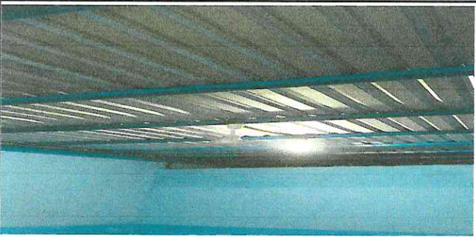
Foto 5: Energía Eléctrica y ventilador instalados.
